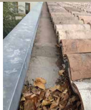
Chéneau sous dimensionné, à l'origine des nombreux dégâts des eaux.
